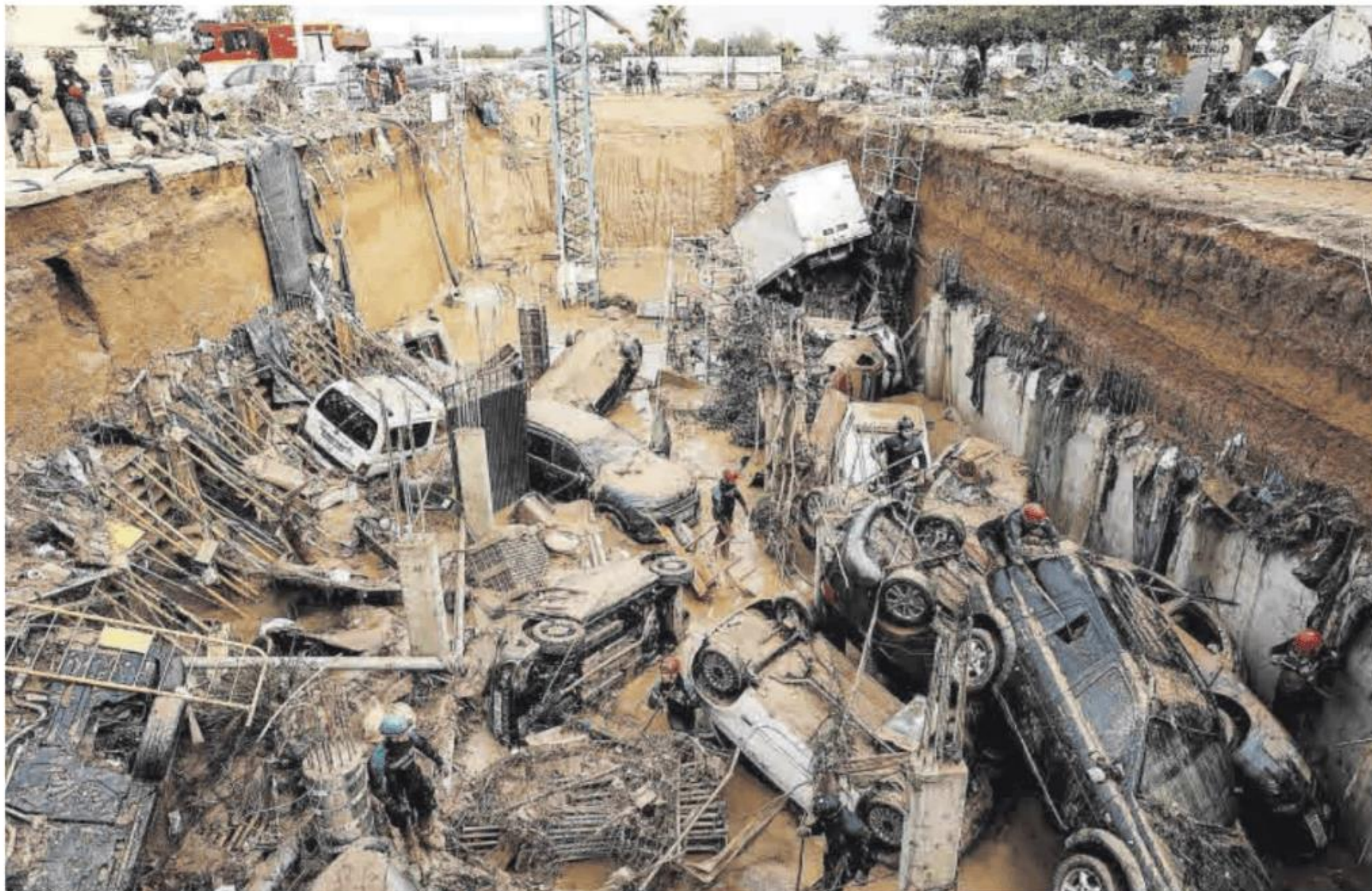
Expertos de la Guardia Civil buscan ayer cuerpos sin vida entre los vehículos atrapados en un edificio en construcción en Paiporta.
